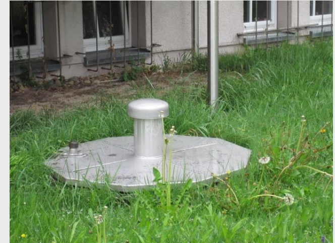
Unter diesem Deckel verbirgt sich eine Regenwasserzisterne
