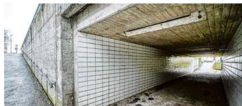
Die Unterführung unter der alten B 10 bei der Firma Allgaier. Die Stadt möchte sie schließen, weil sie Geld kostet. Foto: Giacinto Carlucci
